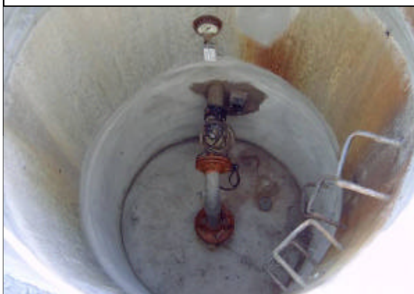
Tørbrønd med taphane til prøvetagning af råvand
